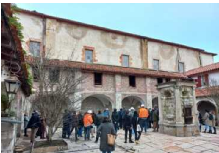
La visite du chantier, qui a réellement débuté le 1 er août 2021, a débuté par la cour du cloître. FABIEN JANS
